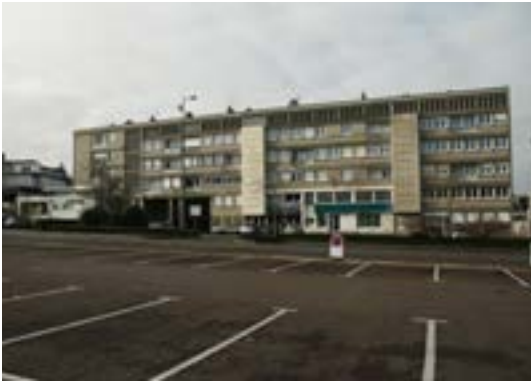
Un rapport au sol chaotique qui révèle la topographie accidentée du sol remblayé
